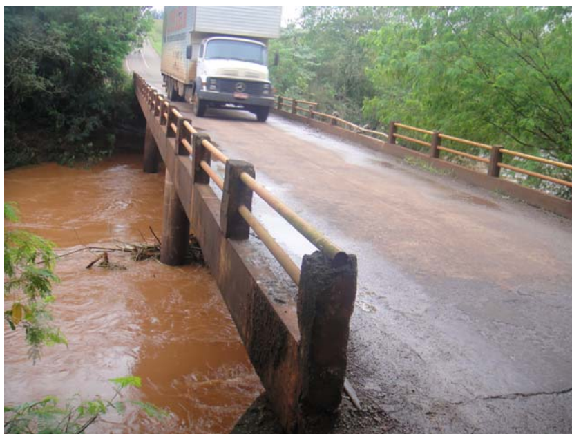
Figura 3.1-4 - Marcas do Acúmulo de água na pista e Galhos presos na Estrutura da Ponte Sobre o Rio da Bulha em Junho de 2013
