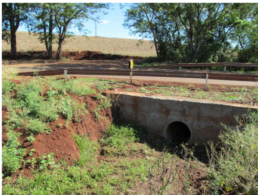
Figura 3.3-3 – Bueiro Implantado recentemente
