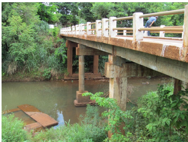
Estrutura Antiga caída no Rio Bananeira
