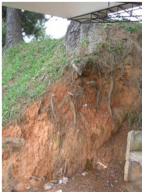
Figura 2 - Ocorrência de solos argilo-siltosos de coloração avermelhada em talude de corte nas proximidades da estaca 40
