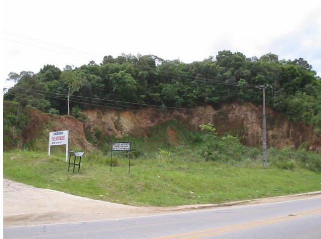
Figura 5 - Talude de corte nas proximidades do Rio Atuba composto por solos residuais com a presença de minerais expansivos
