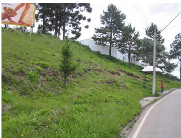
Figura 3 - Talude de corte nas proximidades da estaca 20 com ocorrência de pequenos escorregamentos
