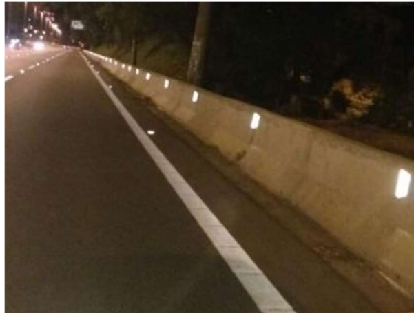
Figura 23 – Balizadores em barreira
