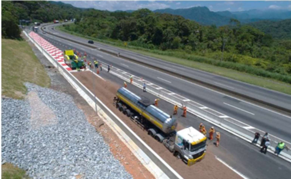
Figura 1 – Área de escape em rodovia
