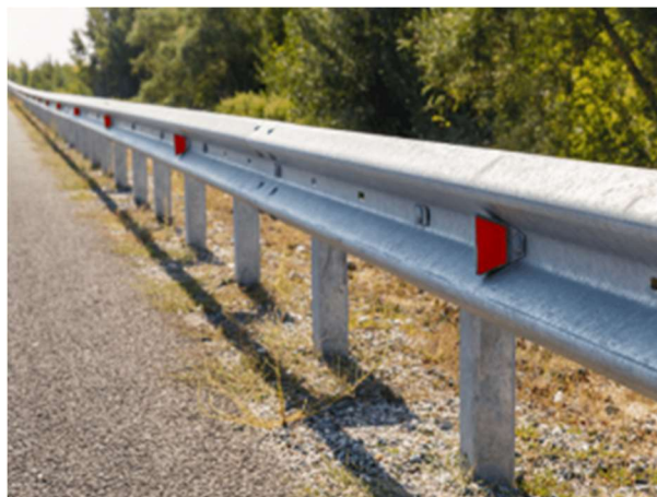
Figura 24 – Balizadores em defensas
