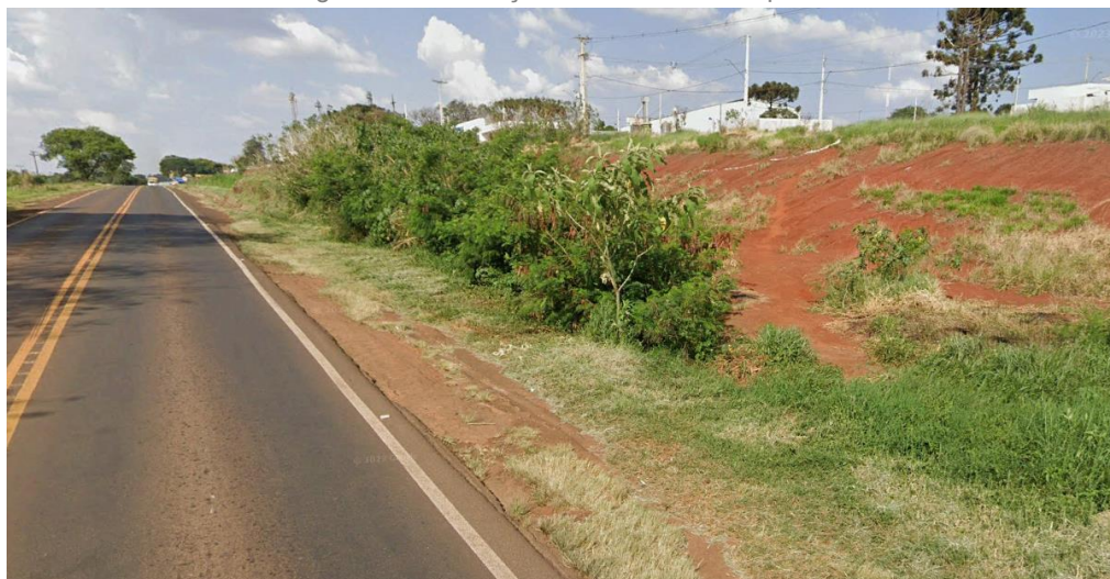
Figura 39: Verificação do desnível entre pistas
