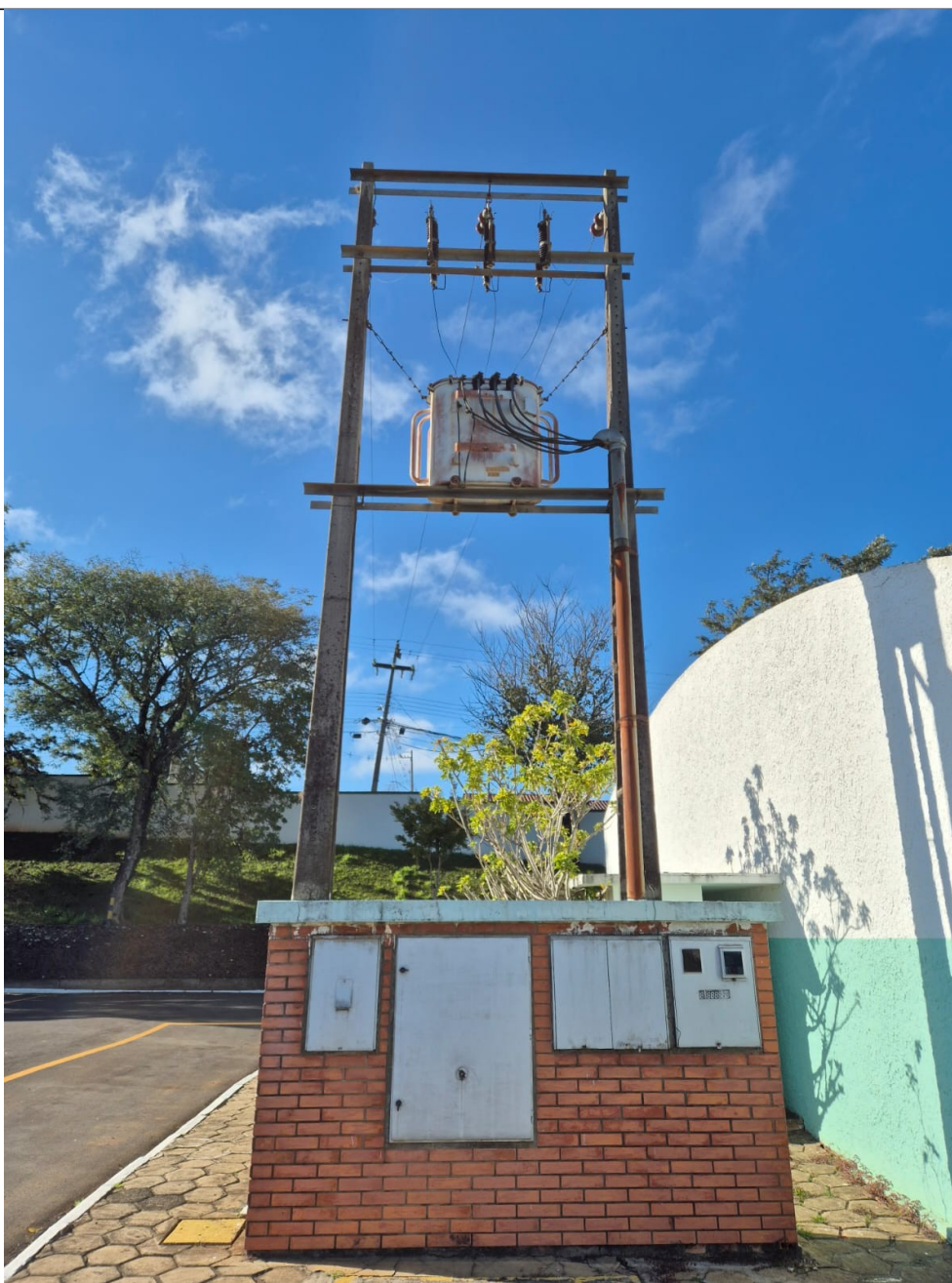
Figura 01 – Visão geral da entrada de energia
