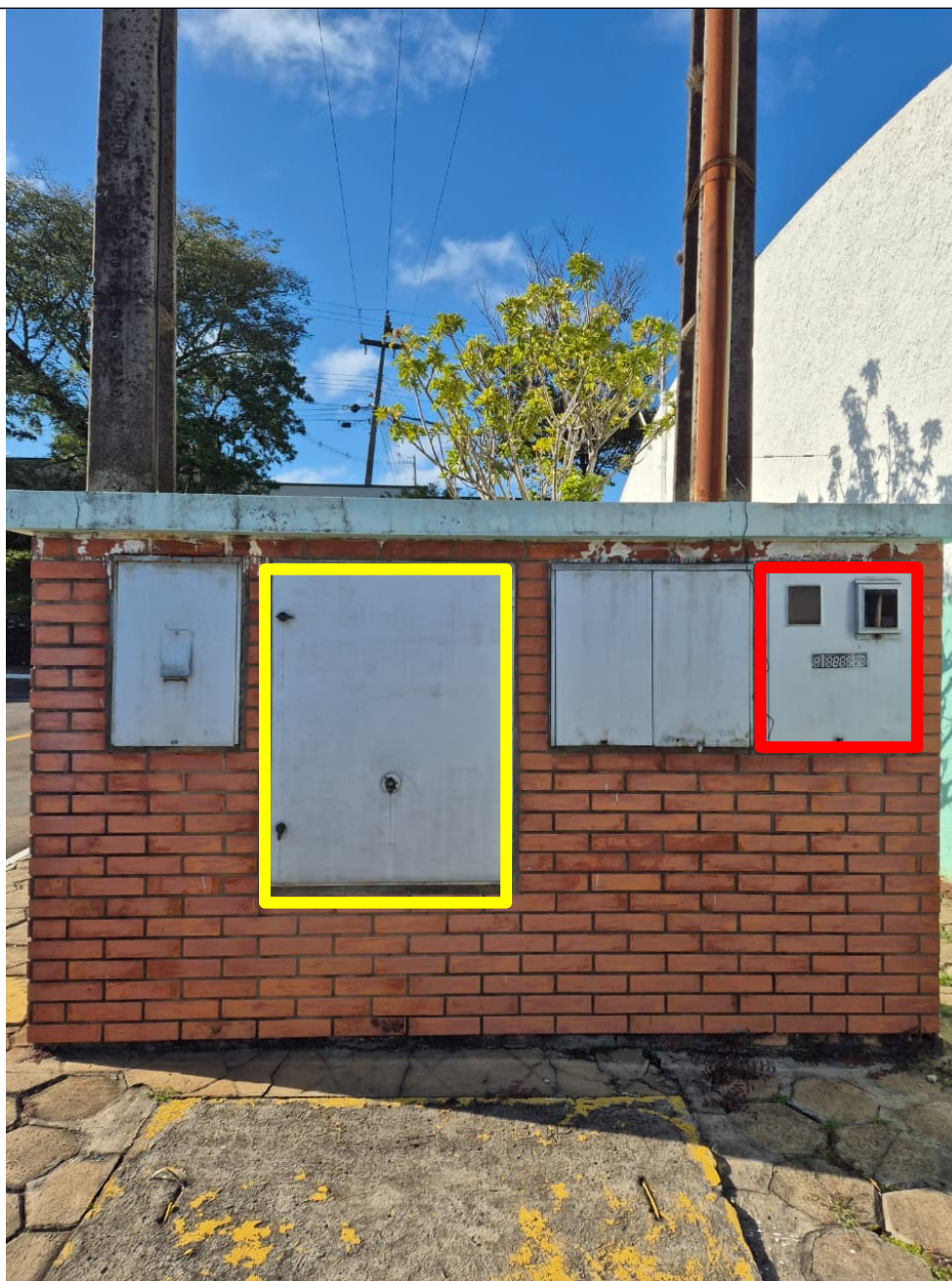
Figura 03 – Caixa FN para TC (amarelo), caixa EM para medidor (vermelho) para substituição.
