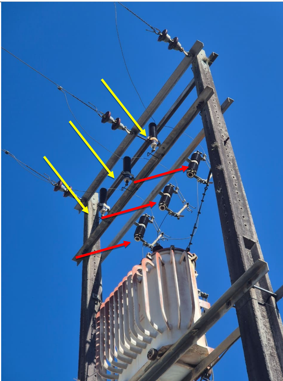
Figura 02 – chaves fusíveis (vermelho) e para-raios poliméricos (amarelo) para substituição.
